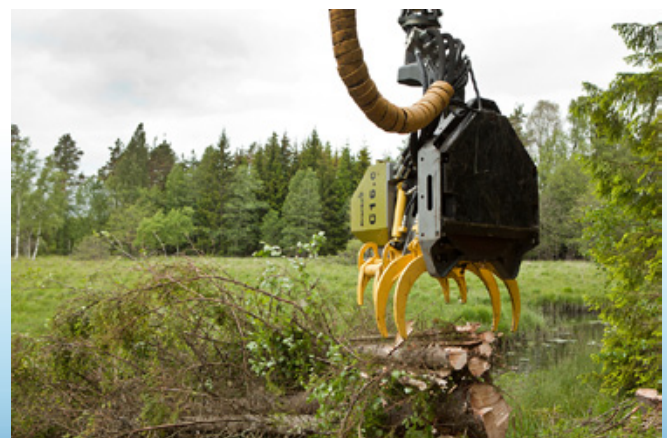
Défrichage efficace combiné à la possibilité de trier des matériaux utiles comme la biomasse.
